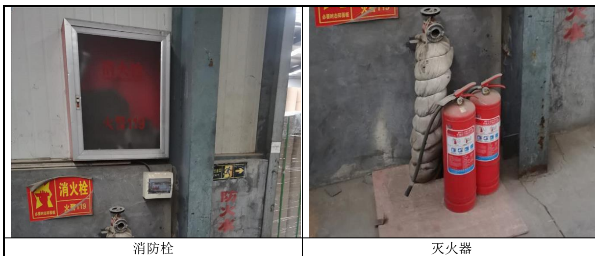
图 6.2-1 消防设施照片
