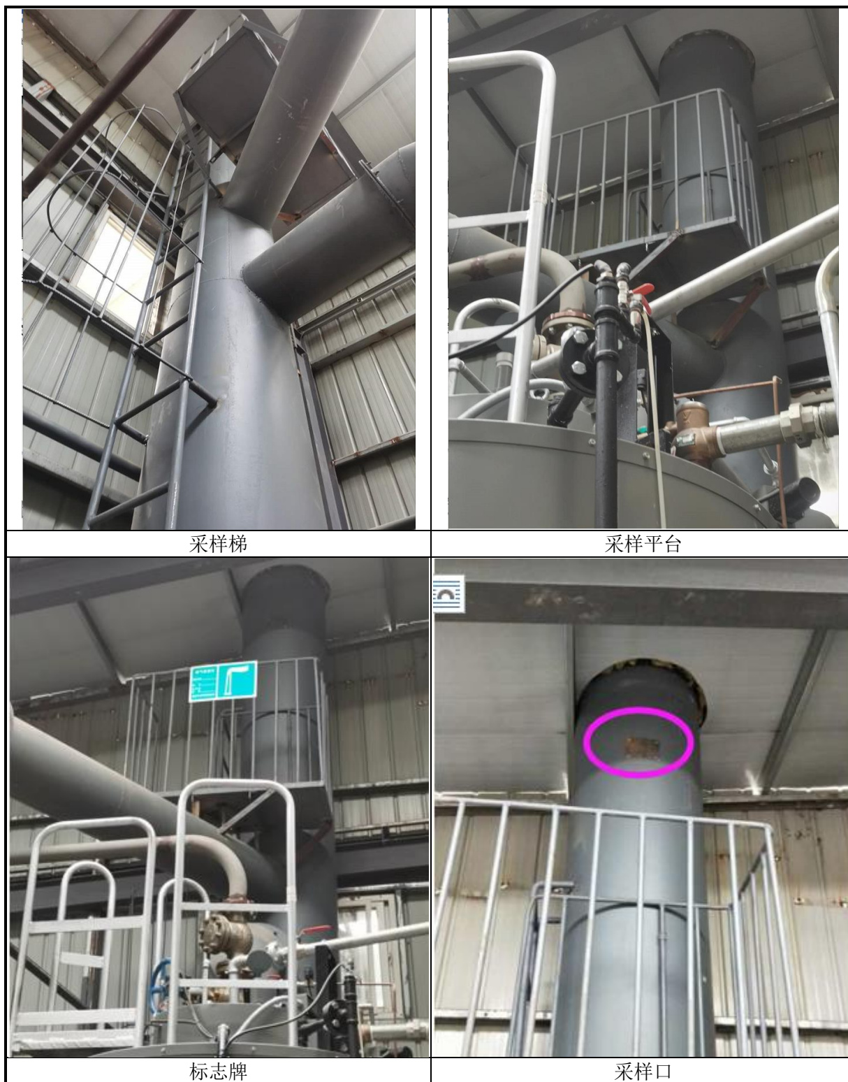
图 6.1-1 有组织废气治理设施图
