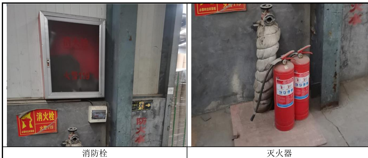
图 6.2-1 消防设施照片
