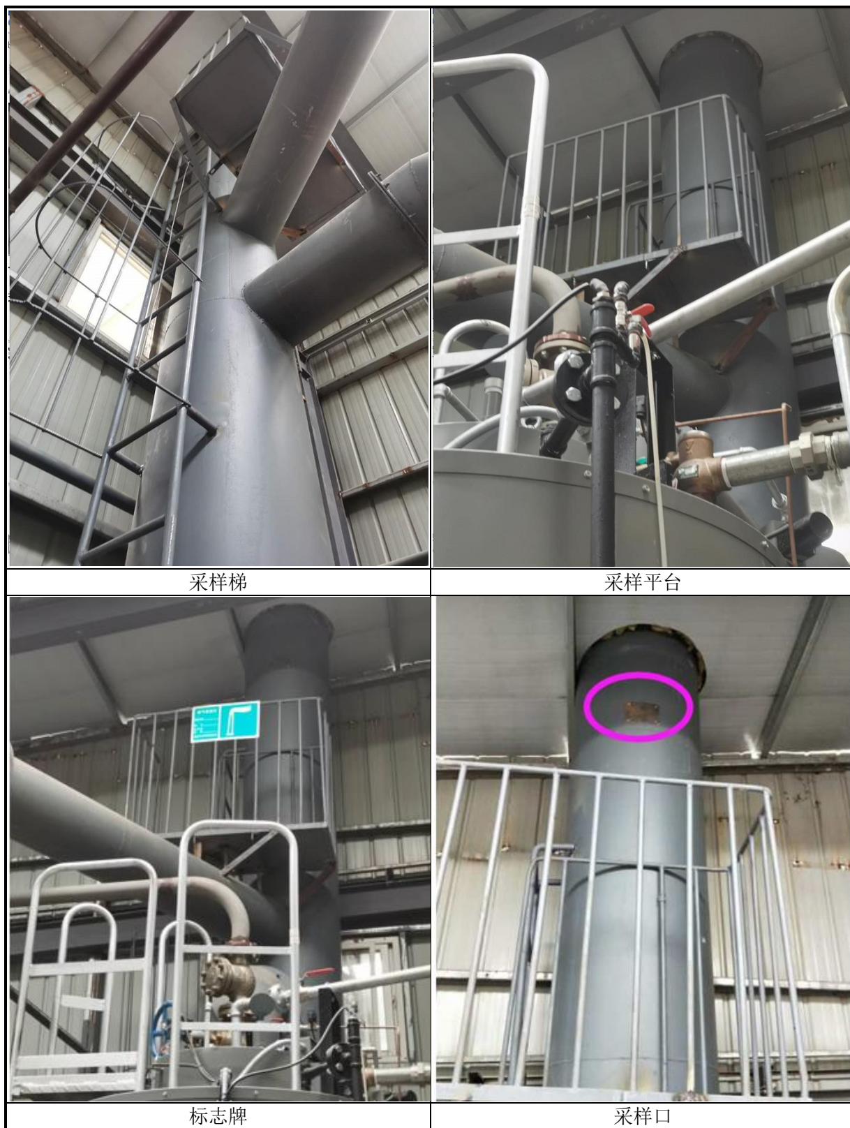
图 6.1-1 有组织废气治理设施图
